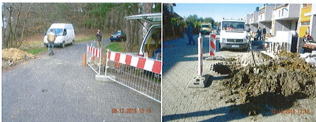
Zwężenia pasa drogowego. W drugim przypadku niszczenie drogi - brak jakiegokolwiek zgody – mandat karny.
