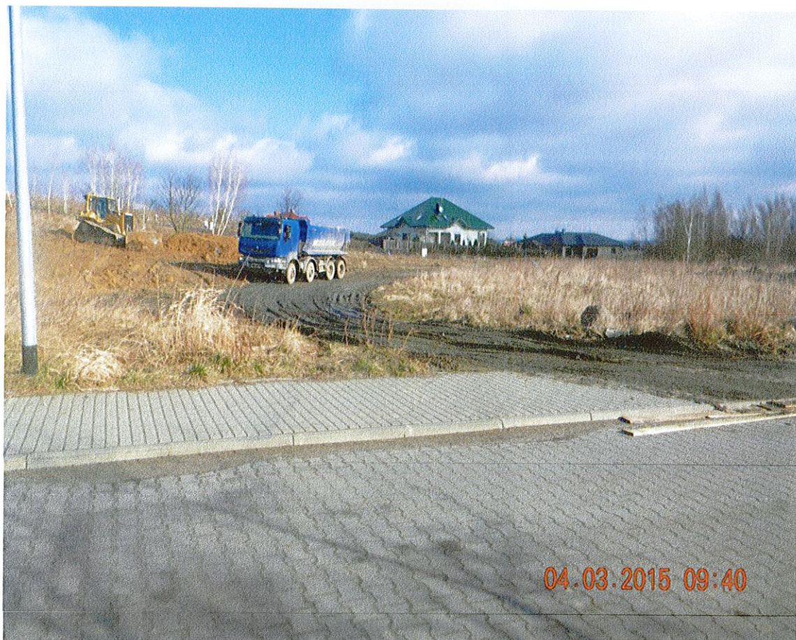
Niszczenie chodnika w Mierzynie. Wniosek do sądu.
